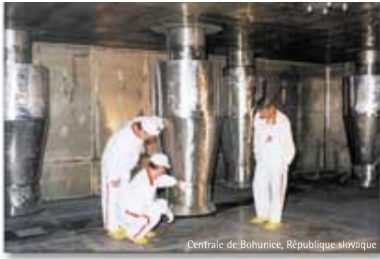
Condenseurs à barbotage à la centrale de Bohunice, en République slovaque.
