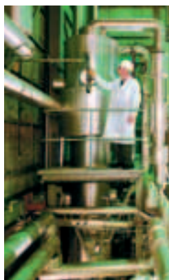
Vue de l'installation PKL en Allemagne.
